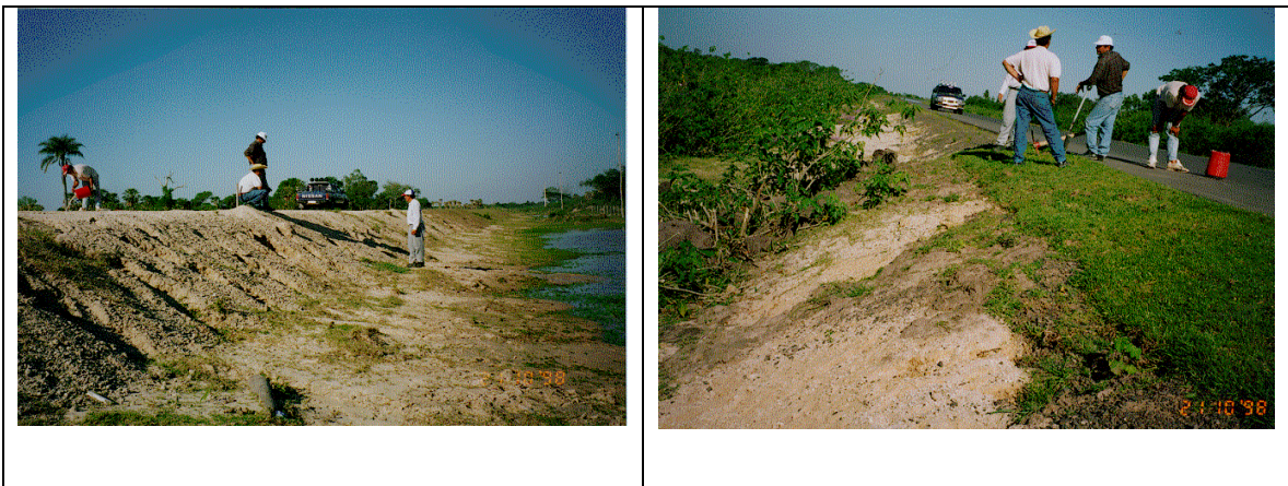
Fotografías de la Ruta 4 en fase de construcción. Se observan los daños.
