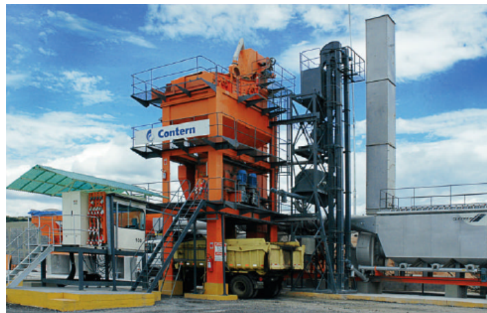
Planta Asfáltica Caliente “Discontinua”
