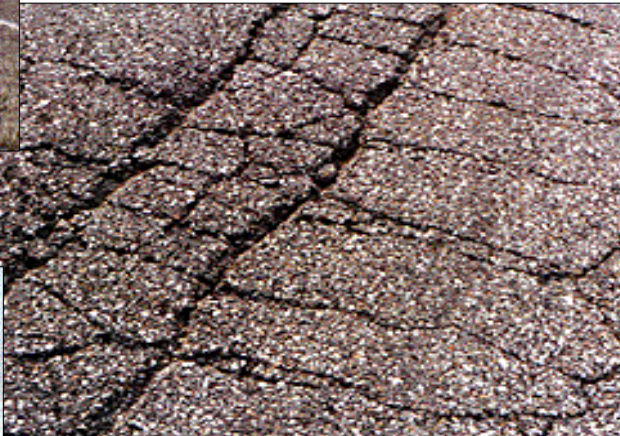
Agrietamiento por fatiga
