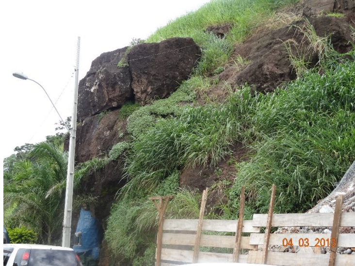
Figura 3. Bloques de roca en voladizo con discontinuidades a la vista.
