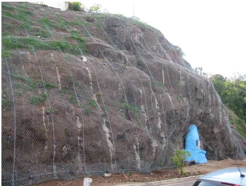
Figura 6. Talud estabilizado con malla "Steel Grid" y anclajes en cuadrícula 2 m x 2 m
