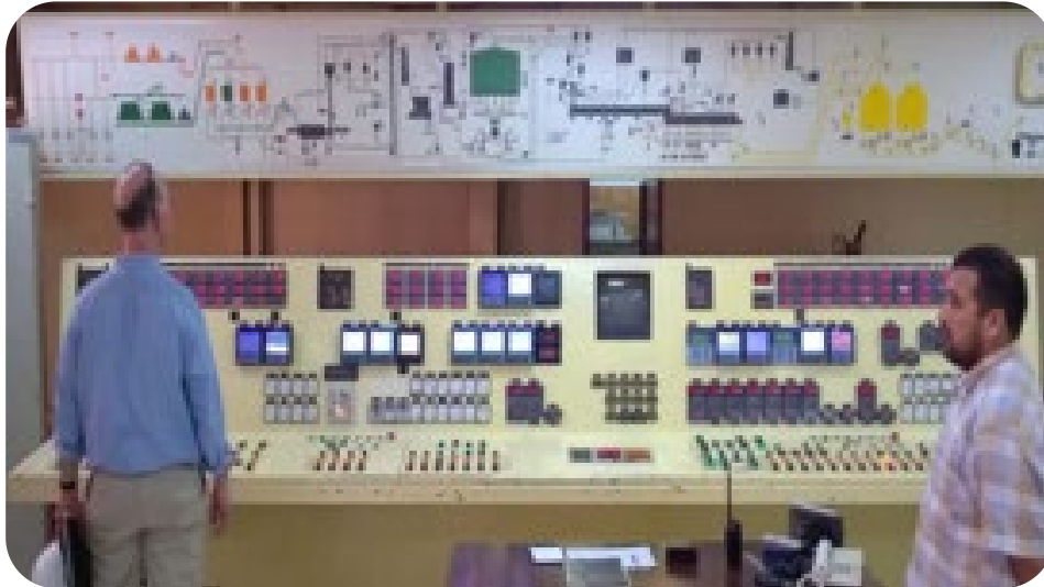
Sala de Control actual en Vallemi
