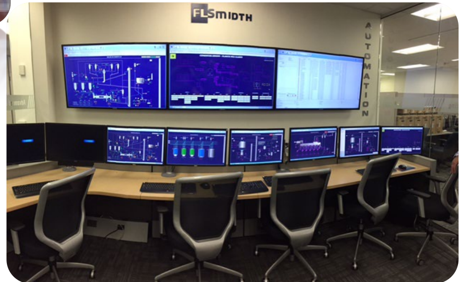
Sala de Control 2017
