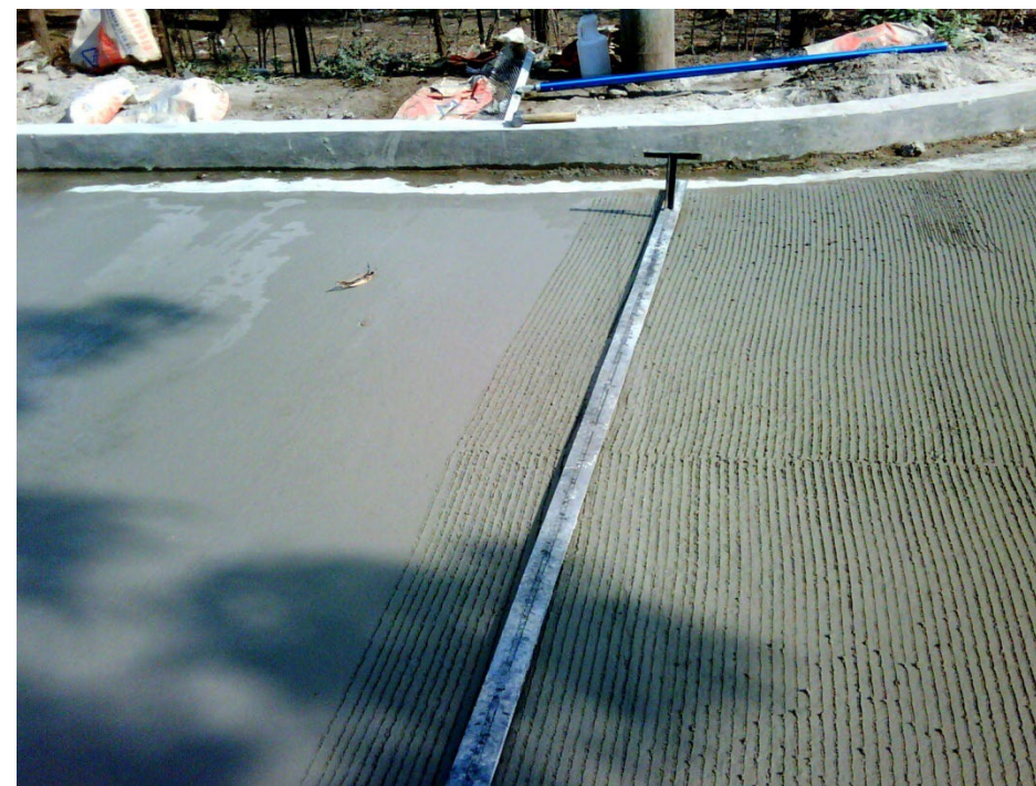
Herramienta hecha en obra para corte en fresco, aplicada en proyectos municipales, de muy bajo tráfico.
