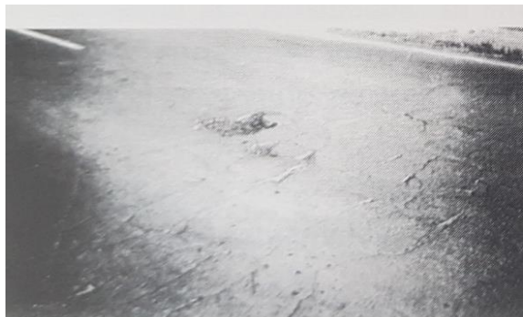
Figura 1: Estado de la calzada antes del reciclado.
