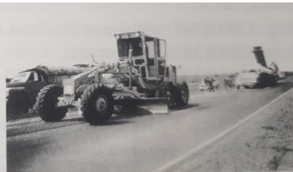
Figura 2: Extensión previa del árido de aportación.
