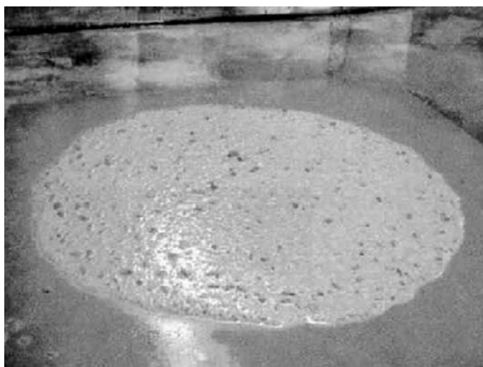
Figura 6.3_42. EVIDENCIA DE UN HALO DE MORTERO Y BRILLO DE AGUA
