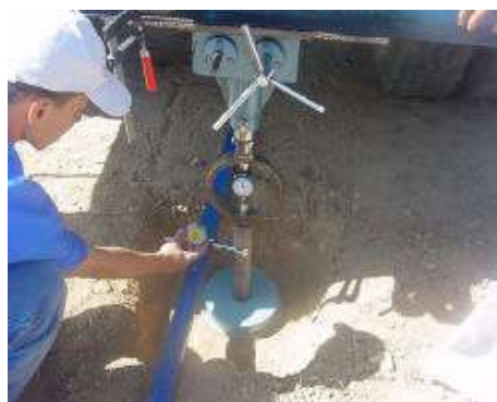
Figura 6.1_202. Instalación de los Diales de Carga
